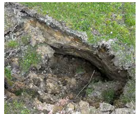
Dammbruch - Gefahr in Verzug (Foto: A. Kittner)
